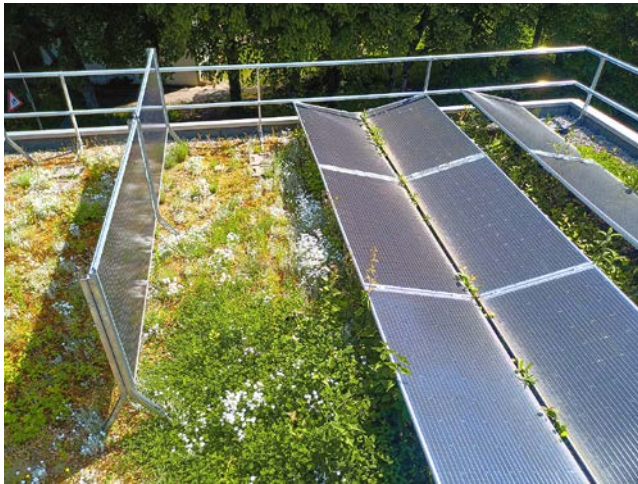
Bei der ersten Testanlage wurde der Kühleffekt der Pflanzen auf die Module untersucht. Werkhof Scheidegg, Winterthur, 2012.
