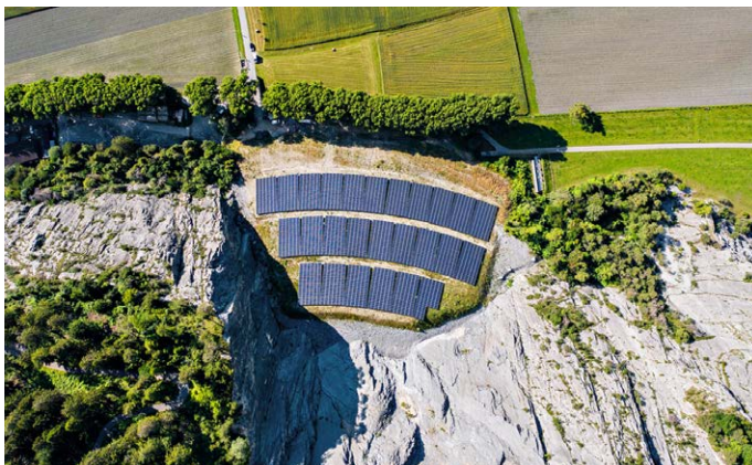
Das herausragende Beispiel: Die Photovoltaik-Anlage im ehemaligen Steinbruch Calinis bei Felsberg aus der Vogelperspektive.
